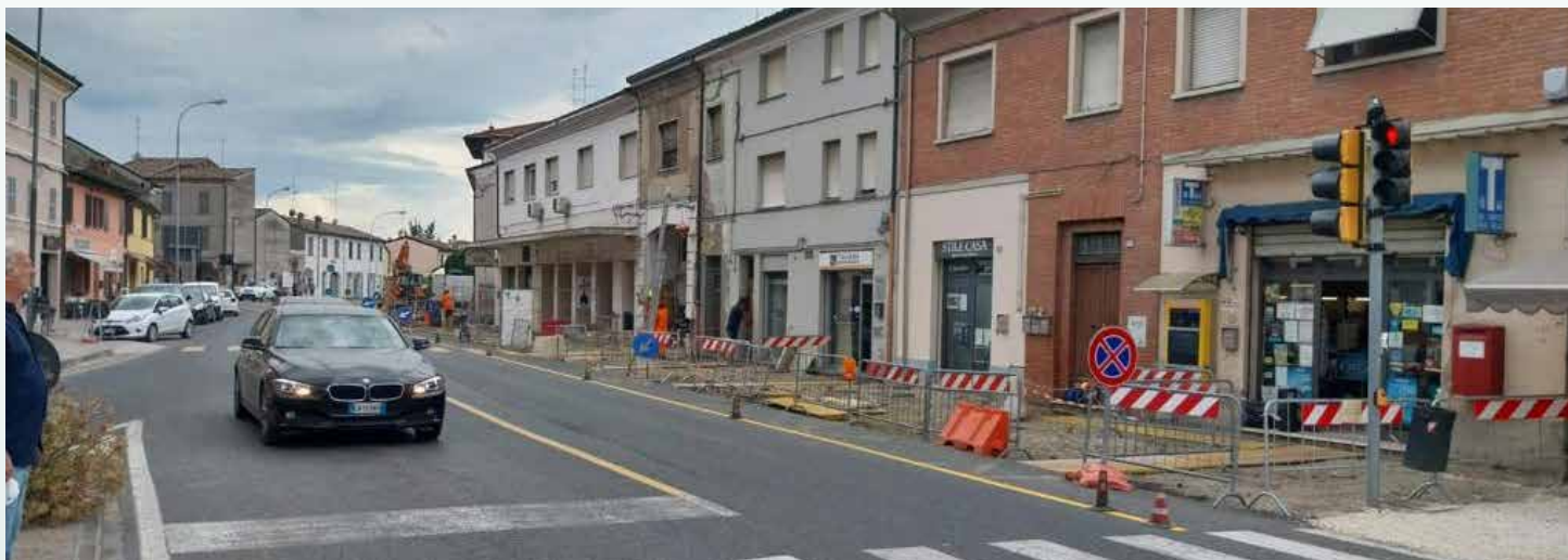
Cantiere in via Garibaldi, nell'ambito del progetto di riqualificazione del centro storico di Russi
